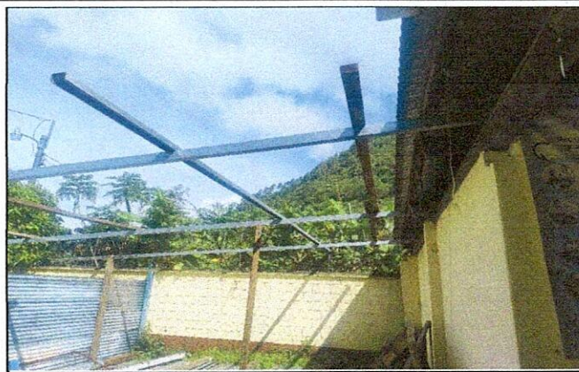
Foto 2: Las láminas que se tenían puestas las botó el aire ya que estas no estaban clavadas y aseguradas, solo estaban sostenidas con madera improvisada.
