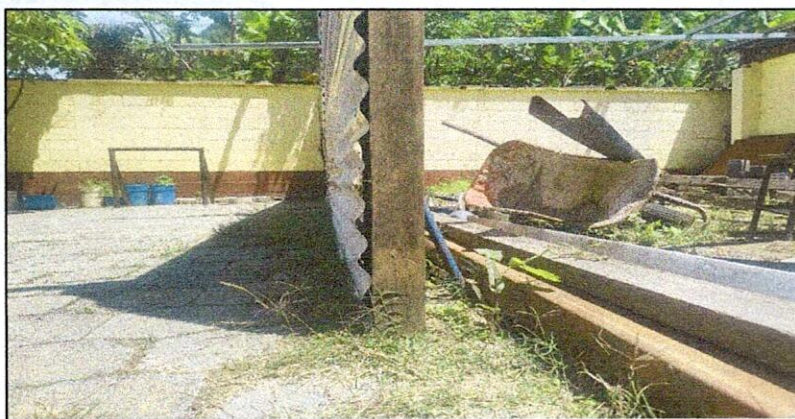
Foto 3: Las bases actuales son de madera y son para corto tiempo ya que con el tiempo se pudren, ocasionando que este no duro mucho tiempo.
